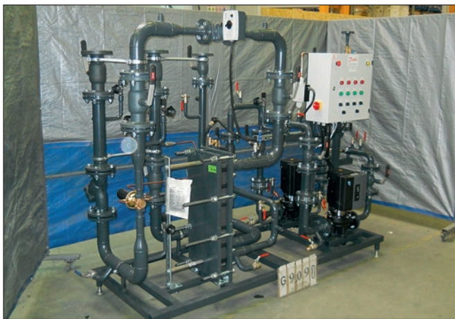
Рис. 44. Автоматизированный тепловой пункт.
